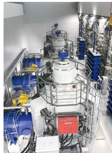
ГЭС «Толга». Новая русловая электростанция оснащена тремя идентичными компактными радиально-осевыми турбинами мощностью 15 МВт каждая.
