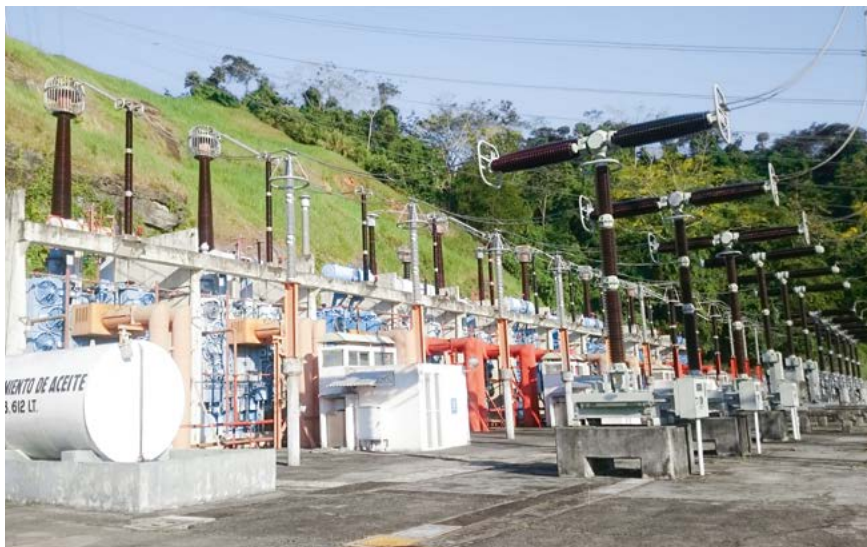
Главные трансформаторы ГЭС «Мальпасо»
